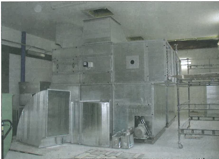
Strojovna vzduchotechniky v nové lakovně.
