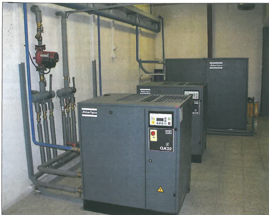
Pohled do kompresorovny vybavené výkonnou technikou.
