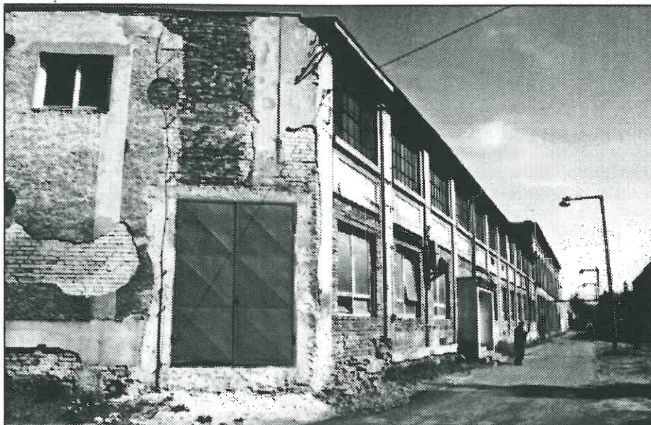
Stav budovy centrálních šaten je dokladem nutnosti její rekonstrukce.
